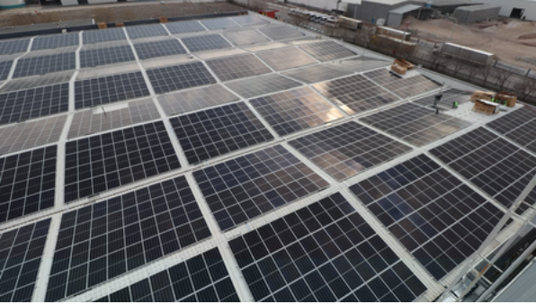
Tekirdağ Çorlu 5900 KWP
