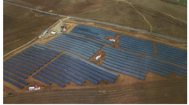
Kütahya Domaniç 1.7 MWP
